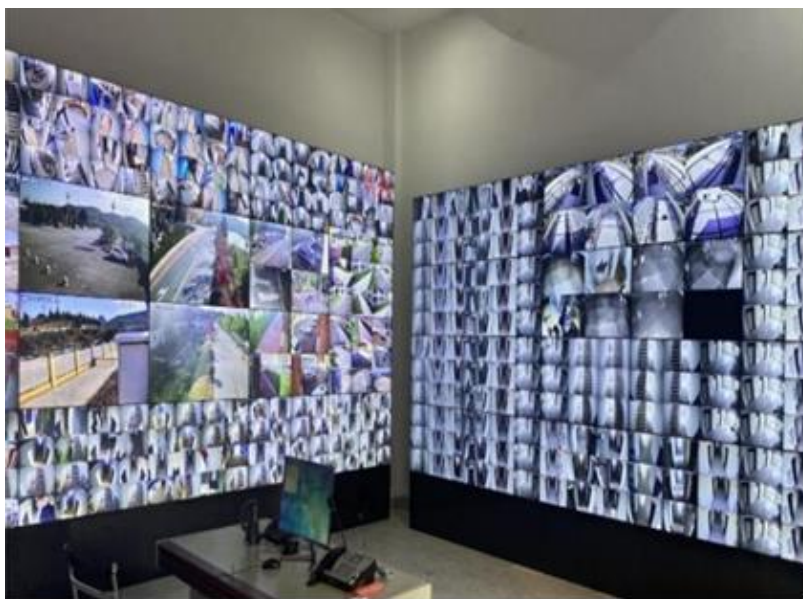
图 2-14 校园监控系统
